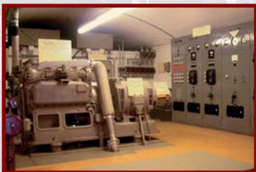
8 Maschinenraum Machine room
